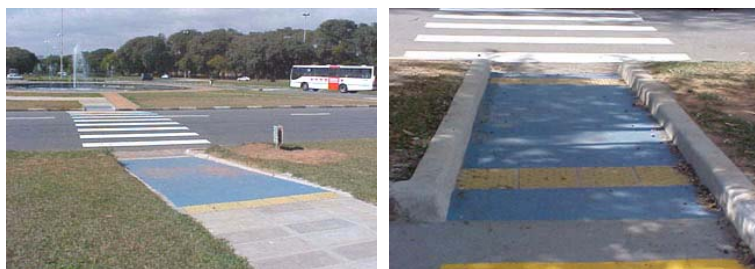
Imagens XXXVII e XXXVIII – Acessos - circulação adaptada – USP, Campus de São Paulo
