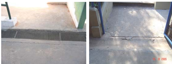
Imagens XXXV e XXXVI – Detalhe da grelha e valeta (respectivamente), instalações inadequadas
