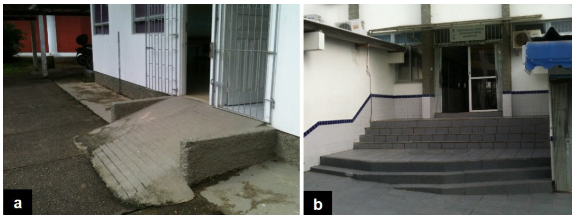
Fig. 3: Rampas muito inclinadas e escadas como único acesso a edificações impedem a entrada de pessoas em cadeira de rodas.
