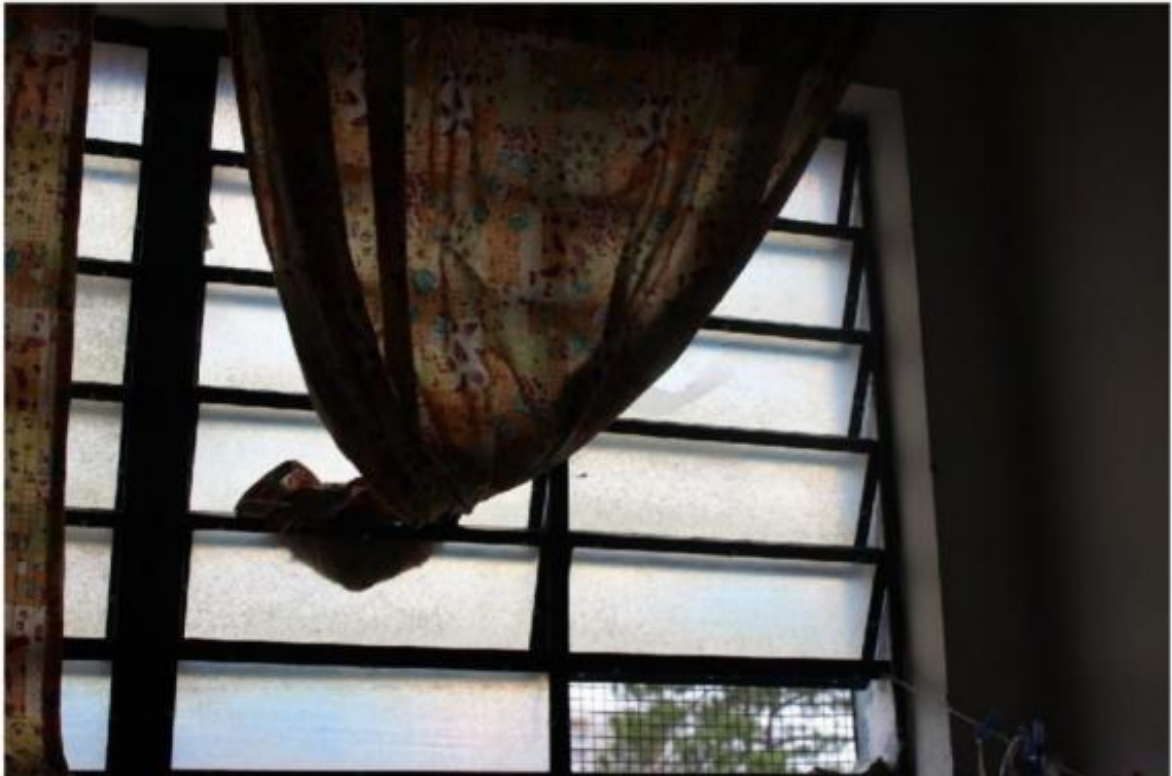
Figura 3 - Janelas com vidros quebrados na ala materno-infantil da Penitenciária Feminina da Capital
