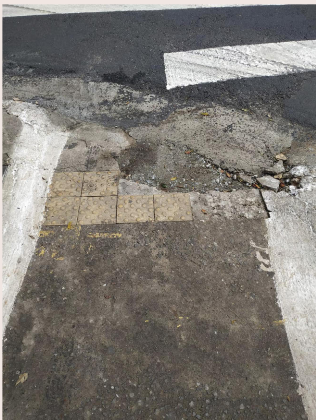
Figura 22 Revestimento com piso tátil de alerta sem algumas peças, gerando buracos no pavimento e aumentando o risco de quedas.
