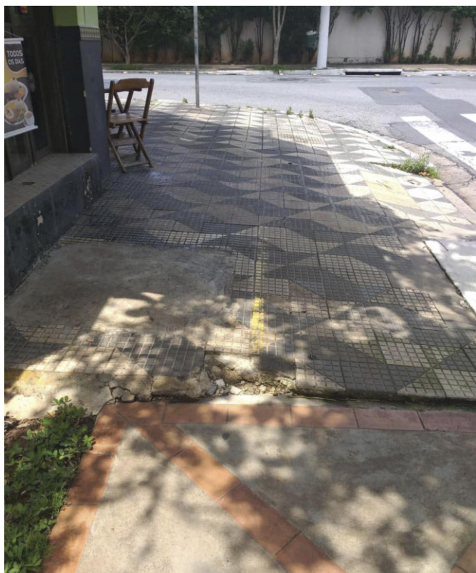
Figura 20 Pavimento com acabamento inadequado, revestimentos diferentes e desnivelados na mesma calçada.
