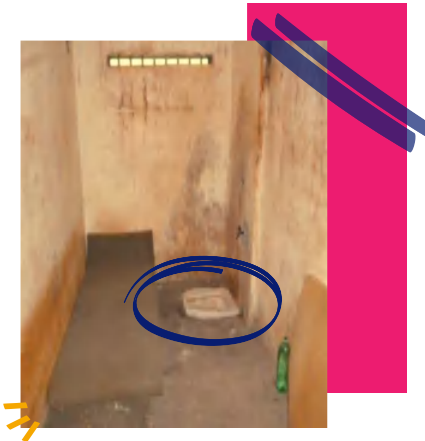
Foto 23 – CDP Masculino de Americana – 26/02/2021 – Cella imunda, insalubre, com diversas infiltrações nas paredes e “vaso turco”.
