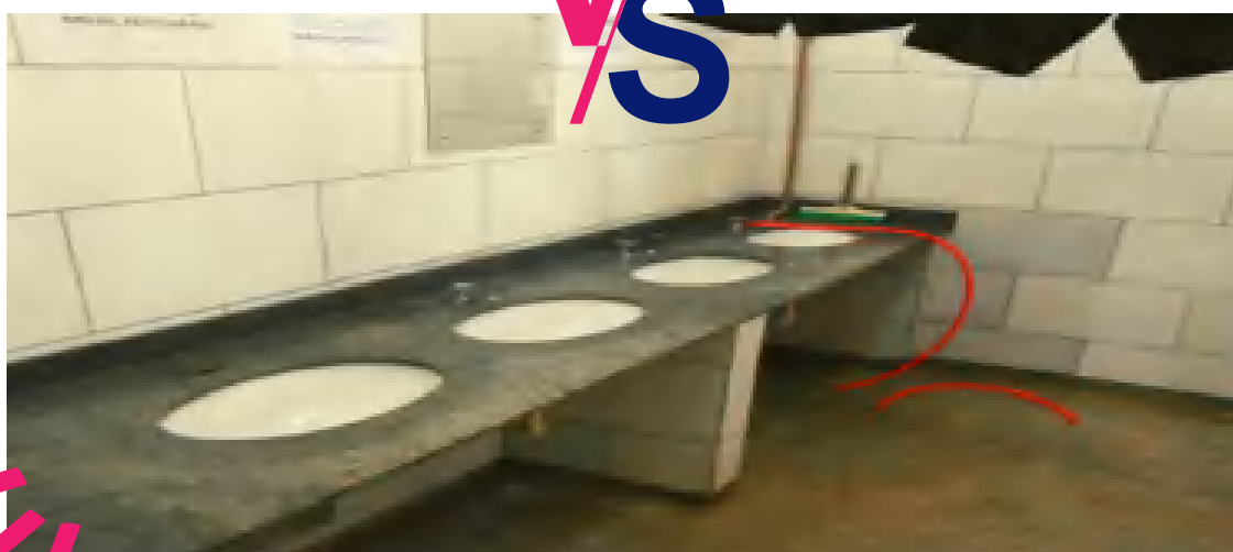
Foto 35 (acima) – CDP Masculino de Santo André – 03/12/2020 – Tanque totalmente deteriorado de pavilhão.
