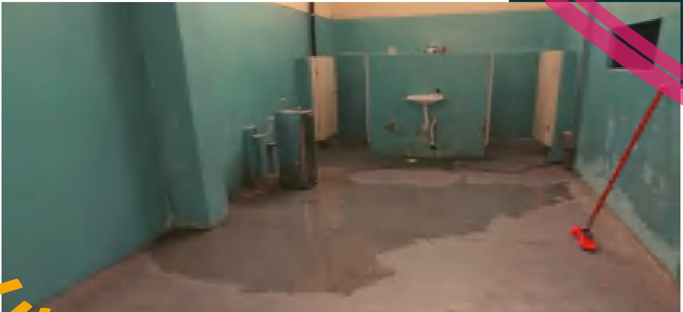
Foto 30- CDP Masculino de Limeira – água vazando no banheiro da escola.
