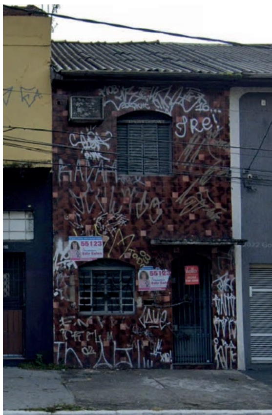
FIGURA 11 Imóvel potencialmente Não Utilizado com janelas quebradas, lacradas ou com fechamento provisório (NU2366).
