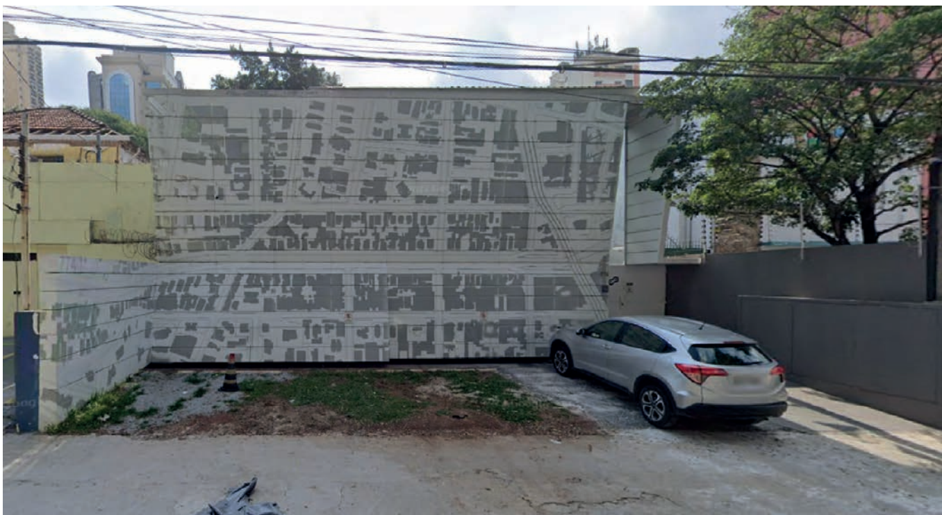
FIGURA 4 Imóvel potencialmente Não Utilizado com janelas quebradas, lacradas ou com fechamento provisório (NU0441).
