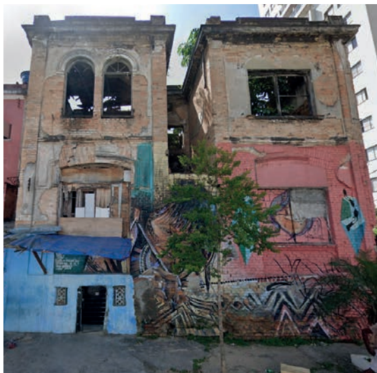
NU0101 – Imóvel na Liberdade em mau estado de conservação
