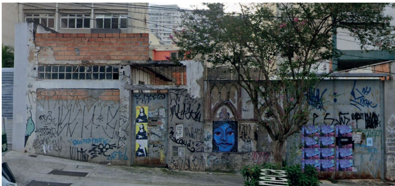
FIGURA 4 Imóvel potencialmente Não Utilizado com janelas quebradas, lacradas ou com fechamento provisório (NU2158).
