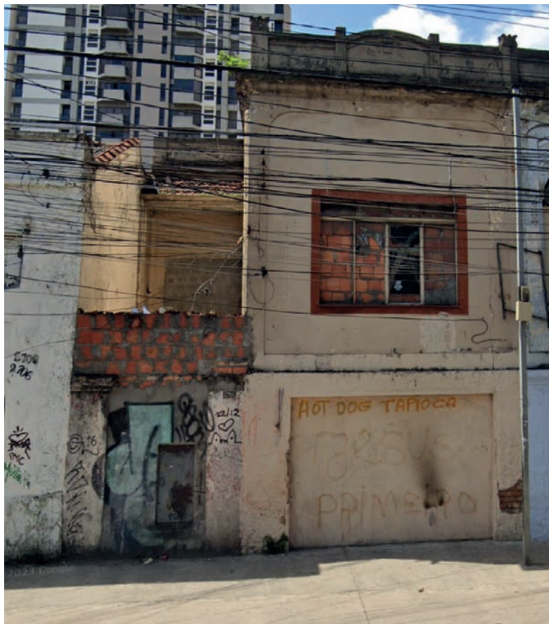
FIGURA 6 Imóvel potencialmente Não Utilizado com janelas quebradas, lacradas ou com fechamento provisório (NU2003).
