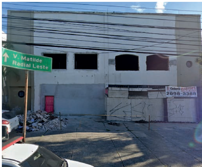
NU1143: Imóvel no Tatuapé, com placas de aluga-se ou vende-se, janelas lacradas e acúmulo de lixo na frente da edificação
