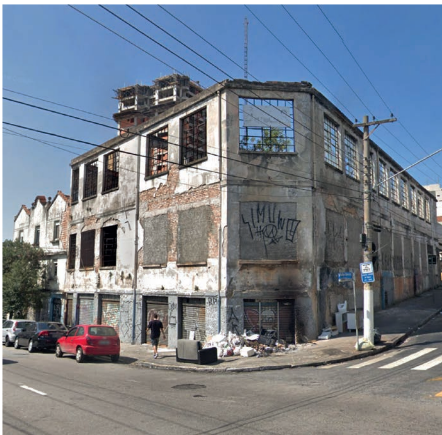
FIGURA 6 Imóvel potencialmente Não Utilizado com janelas quebradas, lacradas ou com fechamento provisório (NU2121).
