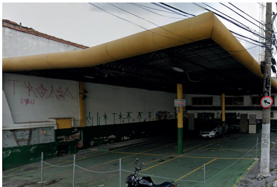
FIGURA 6 Imóvel potencialmente Não Utilizado com janelas quebradas, lacradas ou com fechamento provisório (NU2264).
