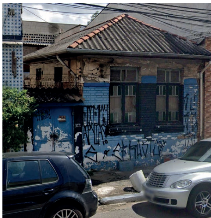
FIGURA 6 Imóvel potencialmente Não Utilizado com janelas quebradas, lacradas ou com fechamento provisório (NU0408).
