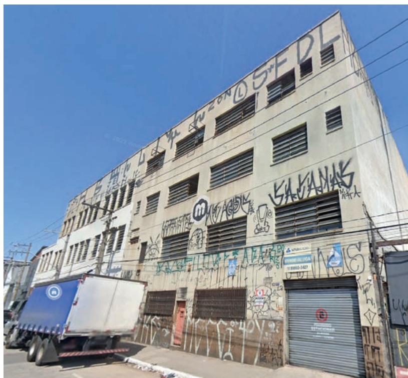
FIGURA 9 Imóvel potencialmente Não Utilizado com janelas quebradas, lacradas ou com fechamento provisório (NU0458).
