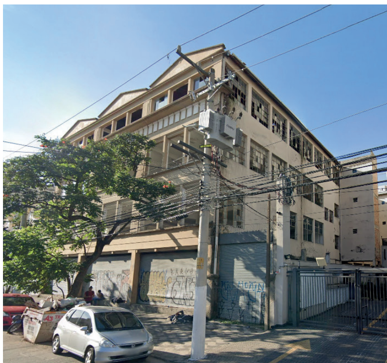
FIGURA 8 Imóvel potencialmente Não Utilizado com janelas quebradas, lacradas ou com fechamento provisório (NU2167).
