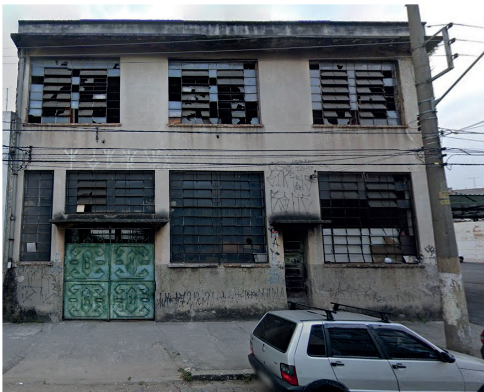
NU0230 – Imóvel no Pari com janelas quebradas, lacradas ou com fechamento provisório
