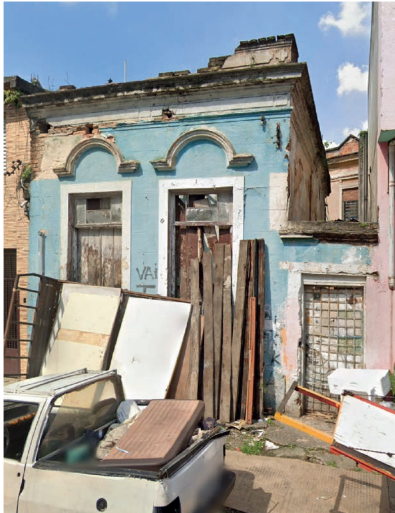
FIGURA 6 Imóvel potencialmente Não Utilizado com janelas quebradas, lacradas ou com fechamento provisório (NU015).
