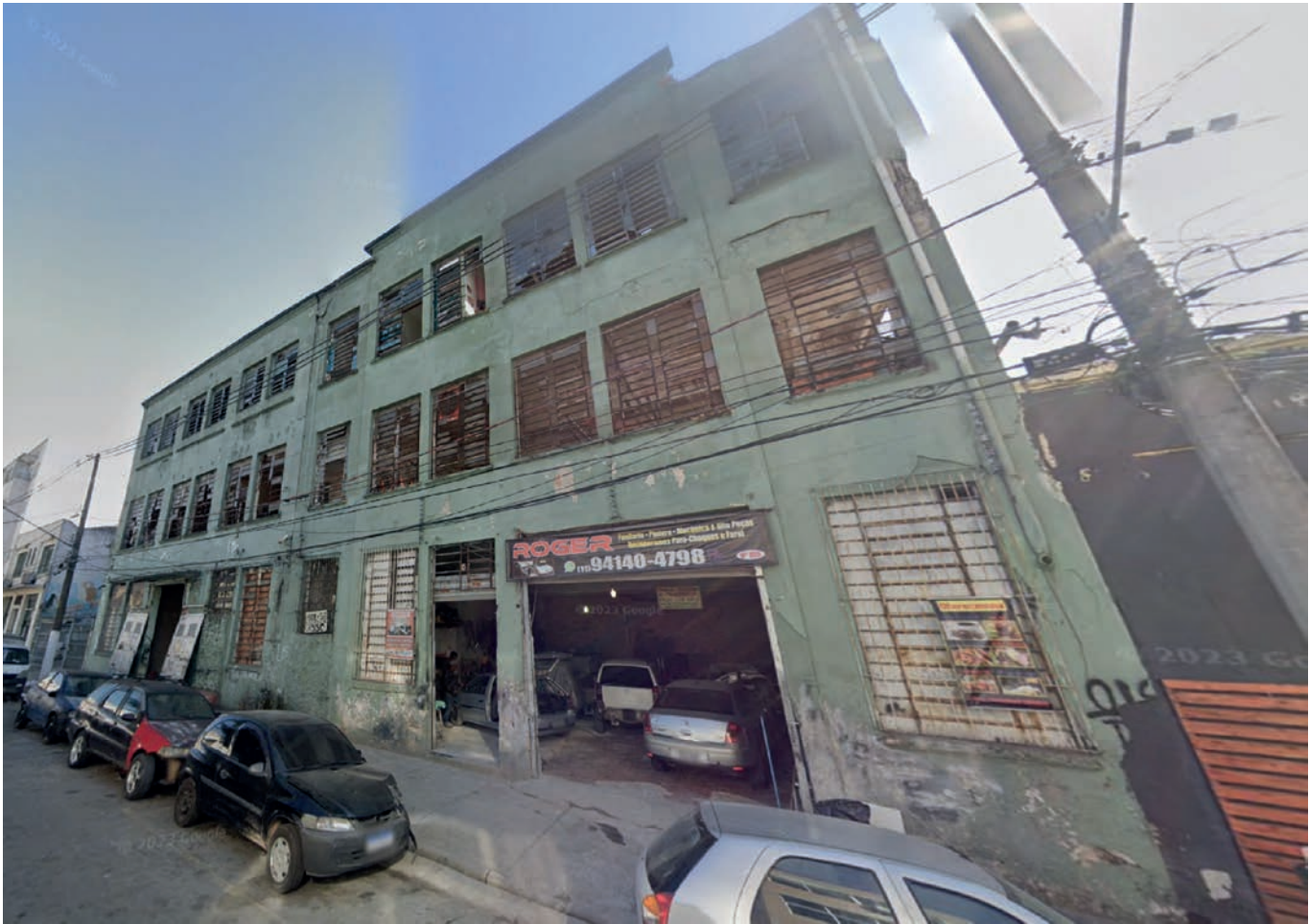
FIGURA 6 Imóvel potencialmente Não Utilizado com janelas quebradas, lacradas ou com fechamento provisório (NU0328).
