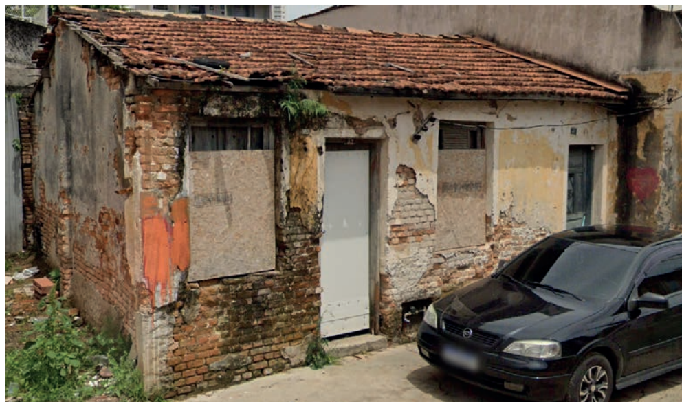
FIGURA 6 Imóvel no Distrito Tatuapé em mau estado de conservação e com a presença de elementos que indicam uso
