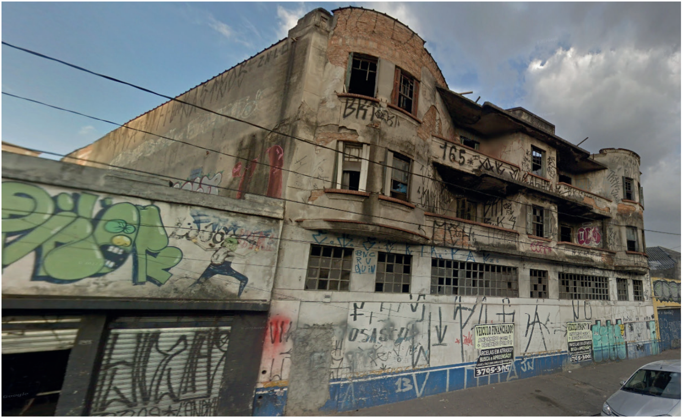
FIGURA 5 Imóvel potencialmente Não Utilizado com janelas quebradas (NU0028).
