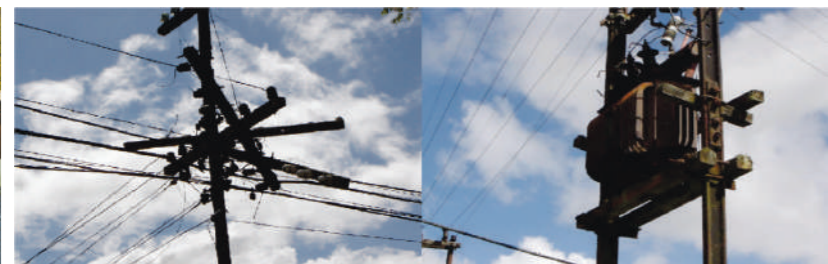
Cruzetas cruzadas e transformador vazando. Foto: PMSA, 2005.
