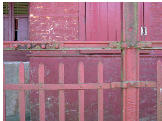
Guarda-corpo com reutilização de trilhos de trem. Foto: Vanessa Figueiredo, 2006.
