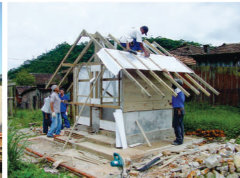
Restauro-piloto das Casas Tipo E-CDARQ: Recomposição dos sanitários externos. Fonte: LIMA, 2008. Foto: LIMA et. al, 2008.
