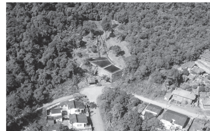
Captação de água do Parque Nascentes direto para o reservatório construído pela SPR. Foto: PMSA/Julio Bastos, 2008.
