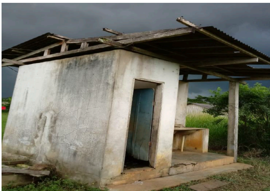
Figura 3: Parte externa do banheiro. Fotografia: DSEI/Divulgação - 2022.
